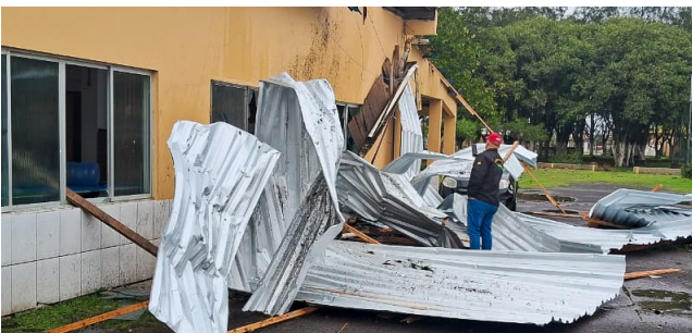
Ciclone que atingiu a CF causou estragos estruturais e exigiu interdição por tempo indeterminado do local. Foto: Arquivo / STIMMEC
