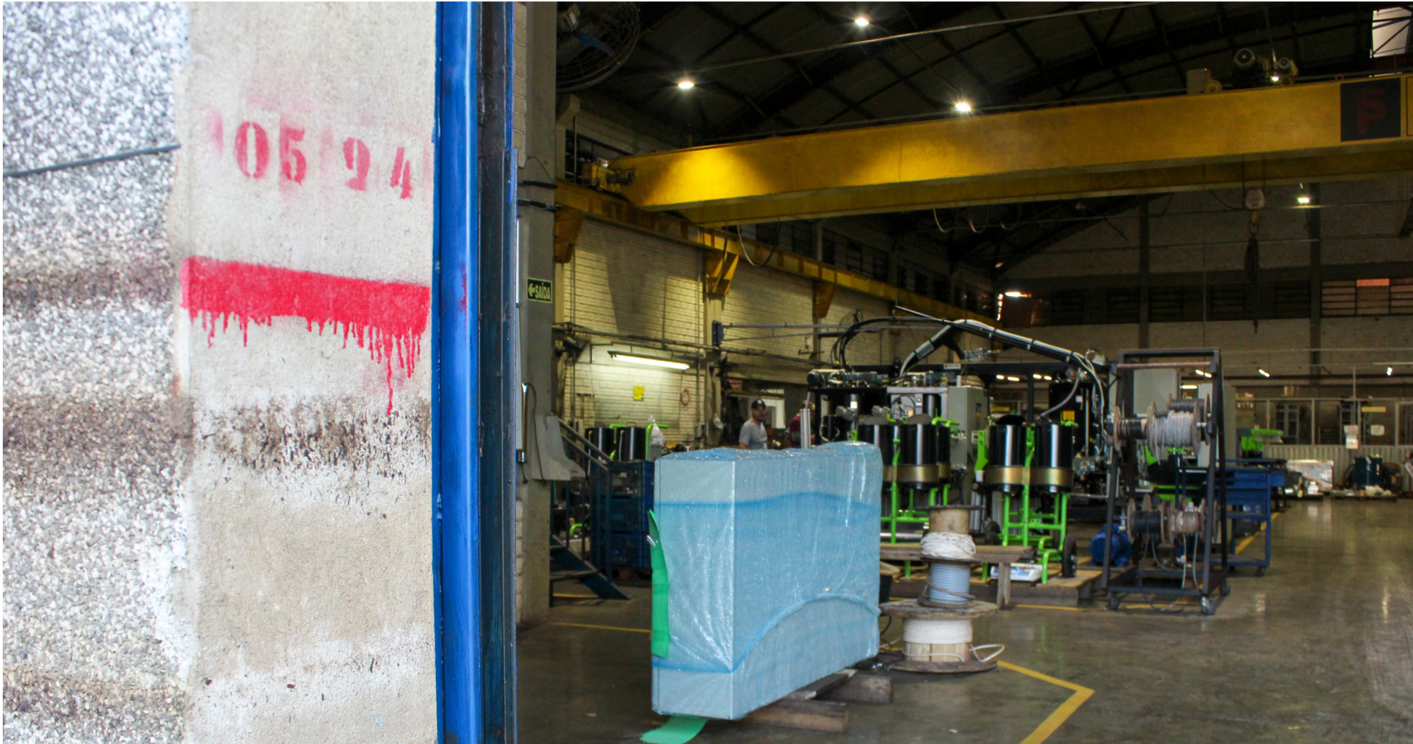
Marcação da altura que a água atingiu em uma metalúrgica no bairro Mathias Velho, em Canoas. Foto: Rita Garrido / STIMMEC
