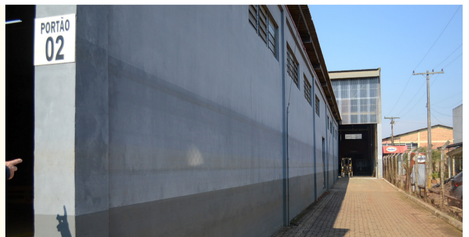
No bairro S o Lu s, marcas mostram que  gua subiu mais de 2 metros.
